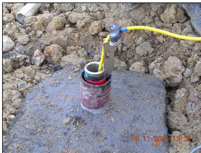
Слика 14.65 Заштита на врвот на инклинометарската конструкција со припрема на бетонски темел
