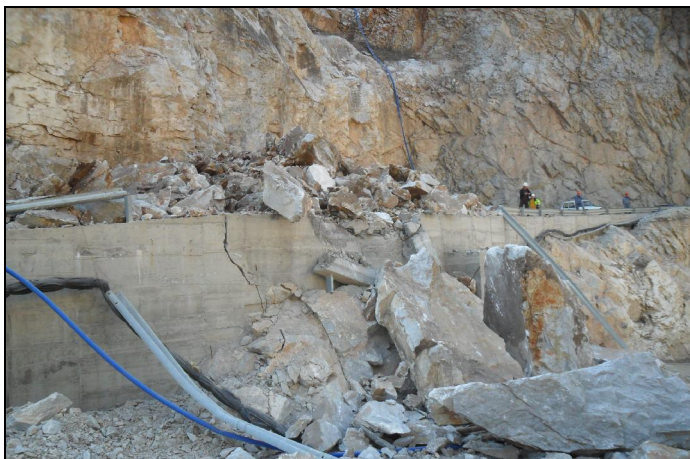
Слика 15.5 Одронување на карпест блок во зона на пристапен пат за браната „Св. Петка“, Скопско, поради комбинација на неповолно ориентиран пукнатински системи (фото З. Николовски)
