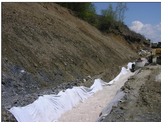
Слика 9.117 Изведба на дренажа составена од комбинација на дренажна цевка, геотекстил (бела маса на фотографијата) и грубозрн материјал во зона на растеретено чело на свлечиште кај Вруточки сифон од ХС „Маврово“
