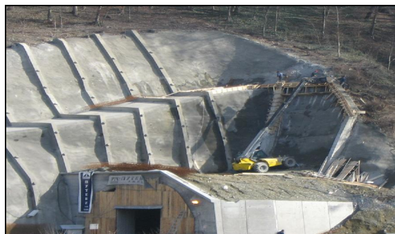
Слика 9.158 Заштита на косина со прскан бетон и армирано бетонски ребра за влез во тунел Мечково Брдо, кај Овчар Бања Р Србија (фото Б. Аболмасов)
