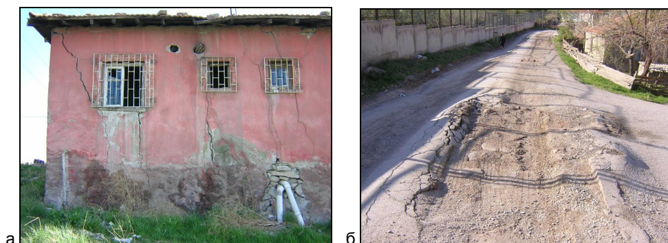
Слика 10.13 а - Деформации на приземен станбен објект, б - деформации на коловозна конструкција заради појава на бабрење на подлогата (Ергулер и Улусаж, 2005)
