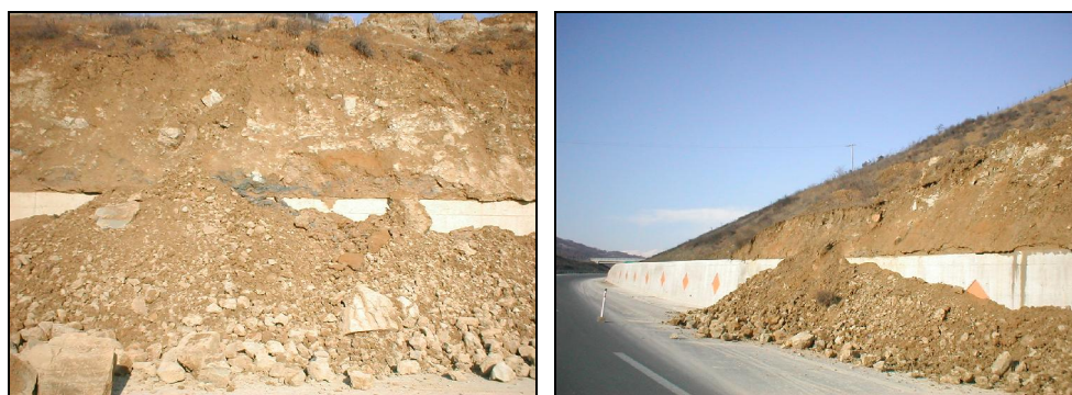
Слика 9.132 Случај на лизгање на материјал над потпорен ѕид, кој, како конструкција е неоштетен (автопат од Скопје кон Тетово во близина на с. Групчин)
