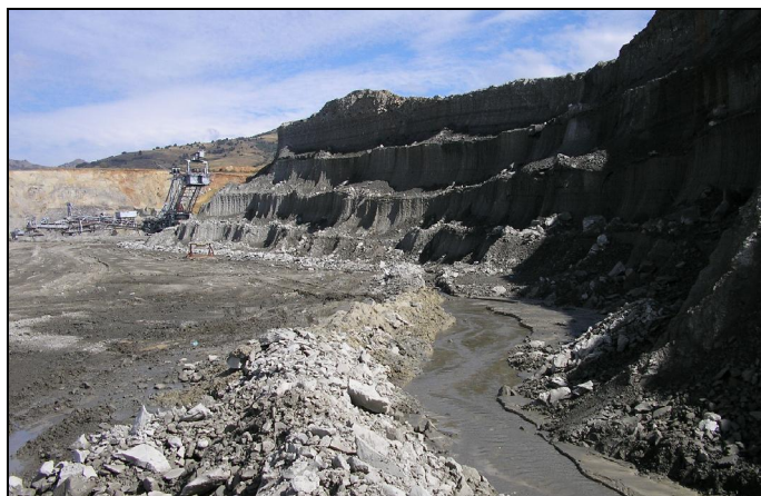
Слика 15.50 Изглед на етажен канал за одведување на подземните води од работен простор за ископ (П. К. „Суводол“ - Битола).
