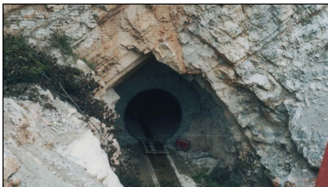
Слика 22.11 Неповолна комбинација на два коси пукнатински системи во излезен дел од доведен тунел на браната „Козјак“ на реката Треска
