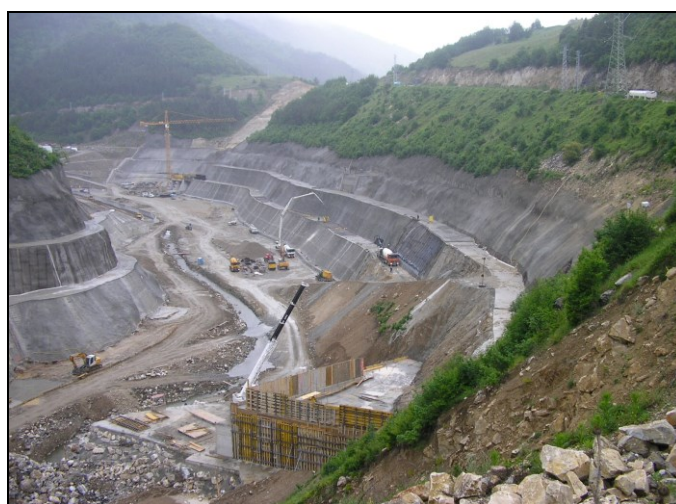
Слика 21.32 Заштита од идни загуби на вода на голем дел од акумулацискиот простор на браната „Ц’нков камен” – Р Бугарија, со примена на анкерисување, прскан бетон, берми и други технички мерки
