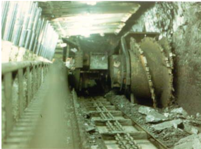
Сл. 21.5. Јамски комбајн со спирално глодало како дел од јамски ископ по методот LONG-WALL
